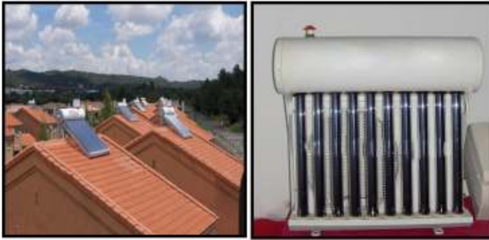
نماذج للسخانات الشمسية فوق سطوح المباني
